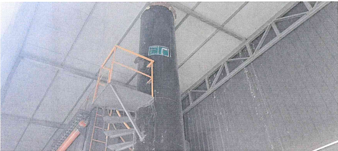
P6 面漆喷涂工序排气筒
