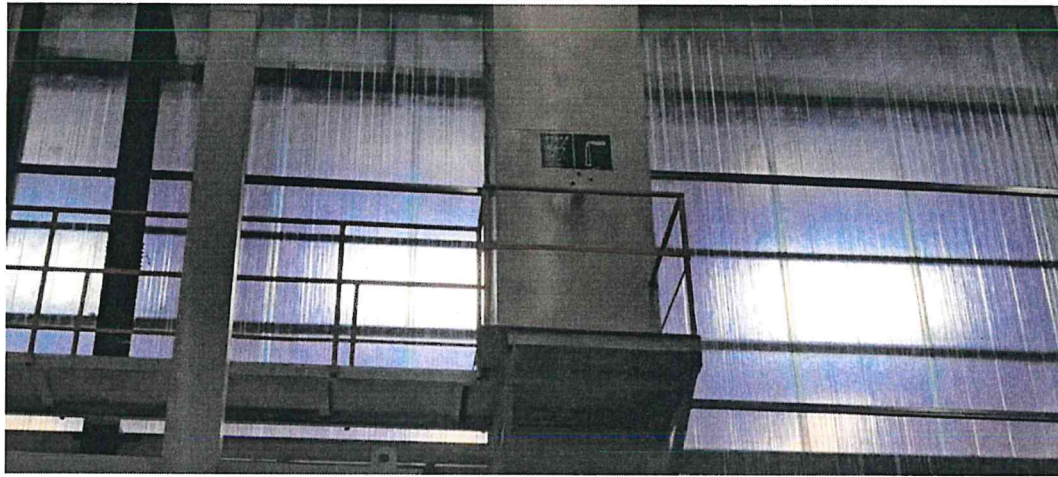
P2、P3抛丸工序排气筒
